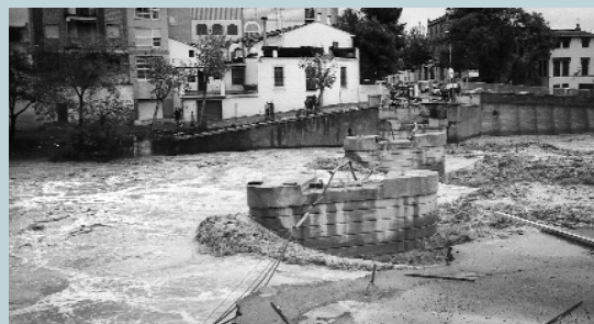
Les obres del Pont Vell es van veure sorpreses per la crecuda del barranc
